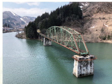
▲被災した第五只見川橋梁
